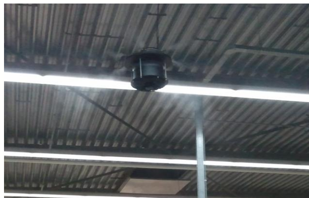
De Airjet wordt middels 4 kettingen aan het plafond bevestigd.
